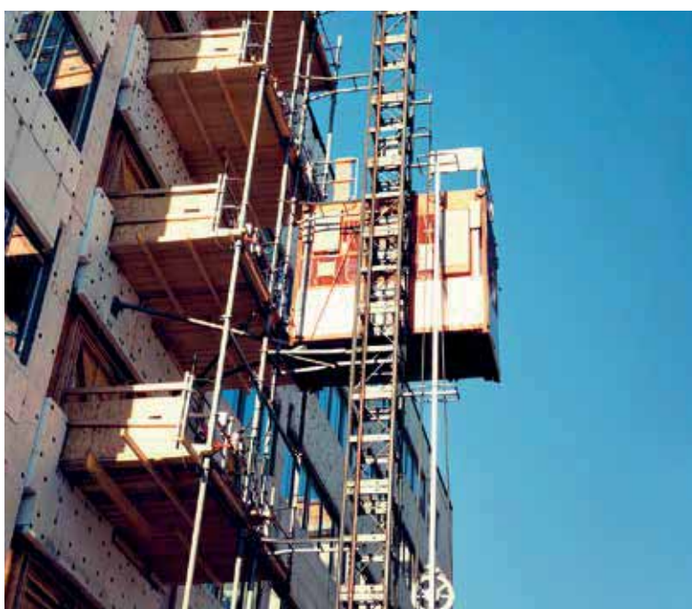
▲ Ascensori di facciata
