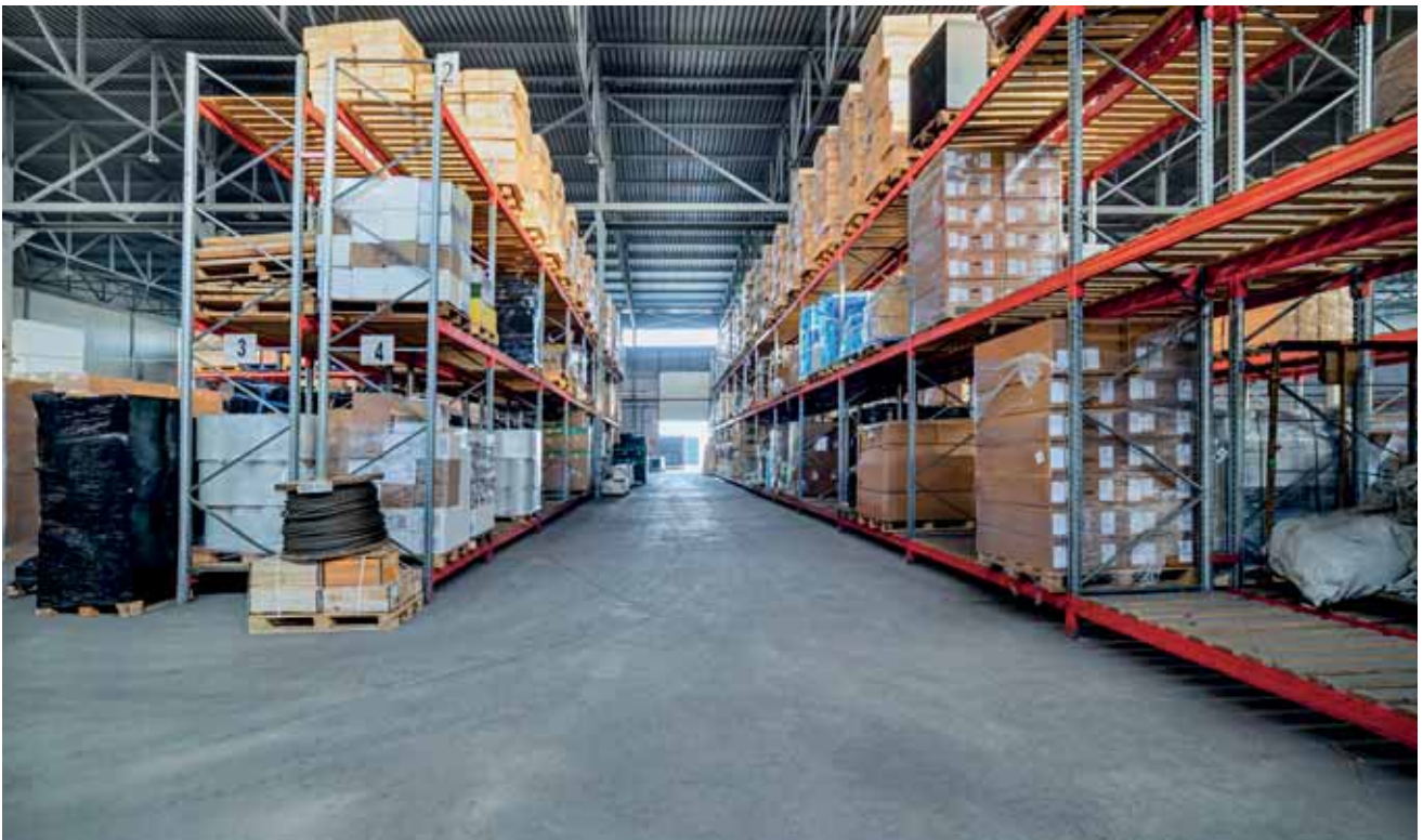
▲ Installazione di scaffalature industriali
