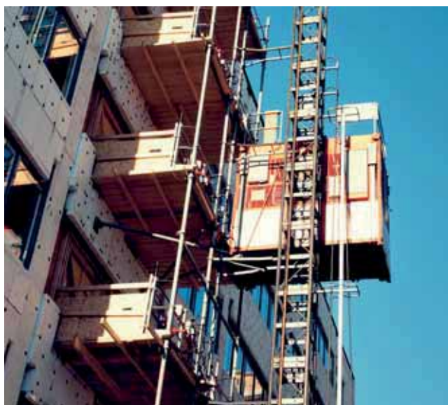
▲ Ascensori di facciata
