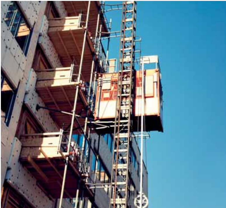
▲ Ascensori di facciata
