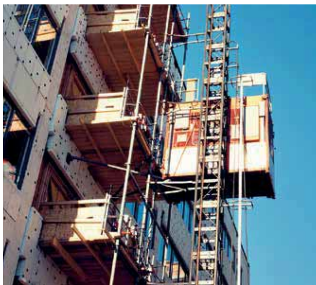
Ascensori di facciata
