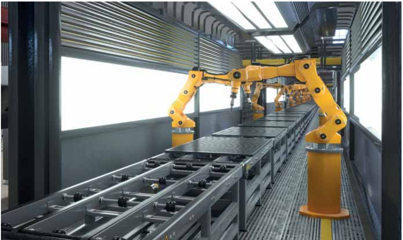
▲ Installazione di linee di montaggio e attrezzature robotizzate
