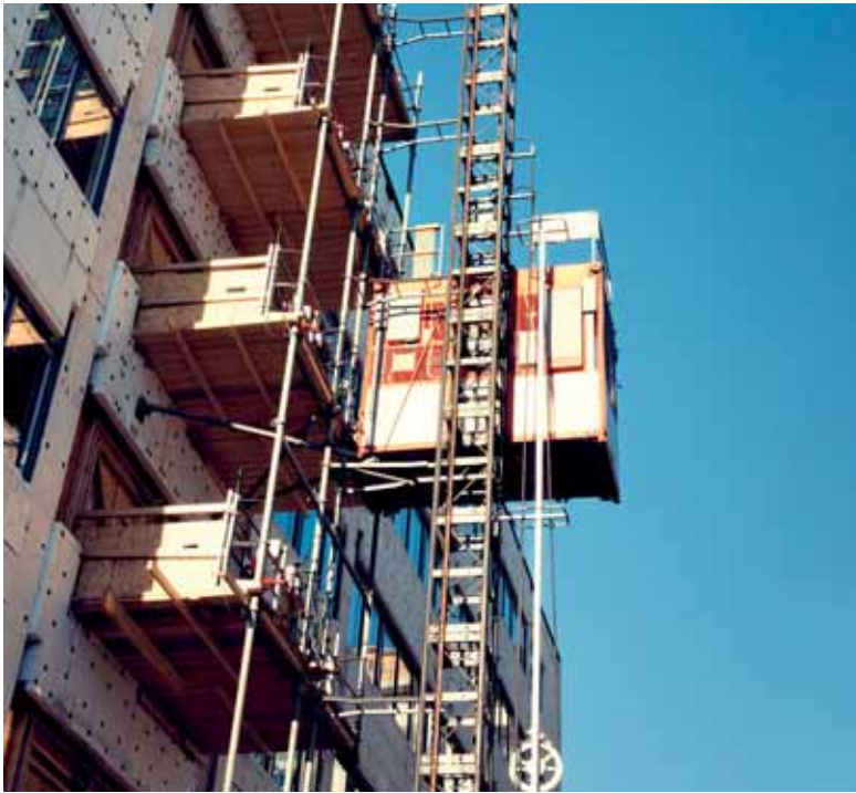
▲ Ascensori di facciata
